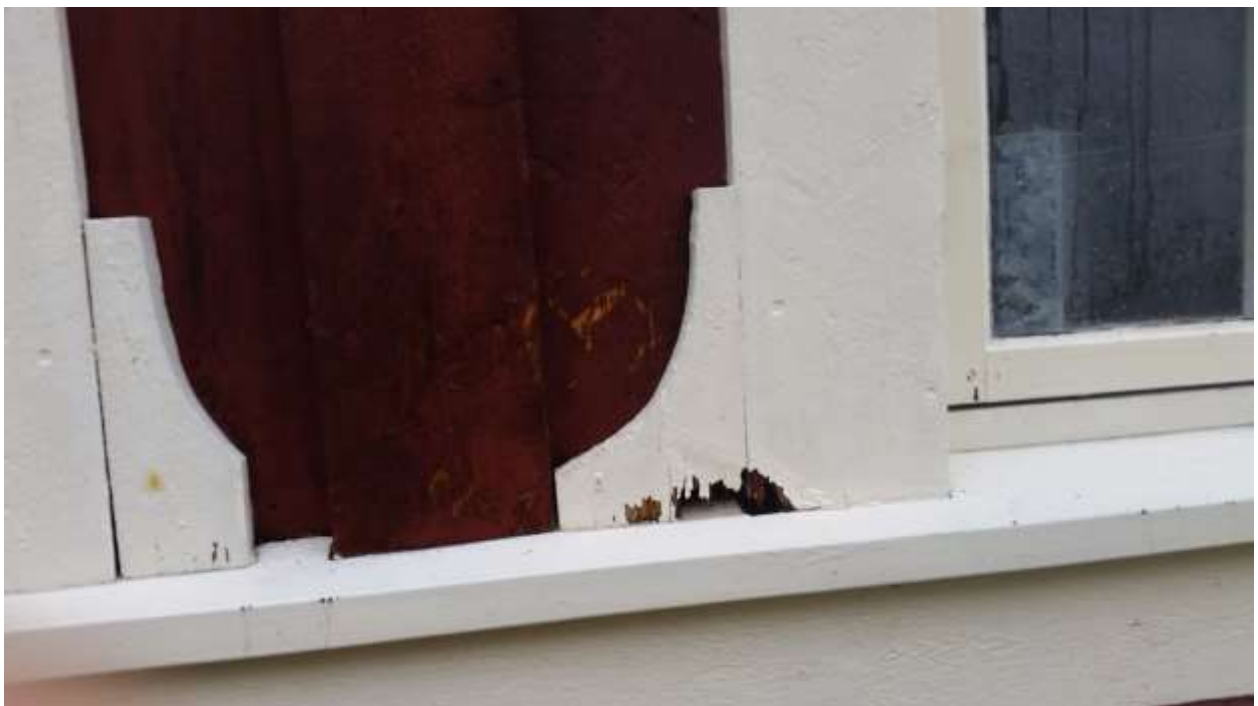
Figur 236. Røteskade ved vassbord
