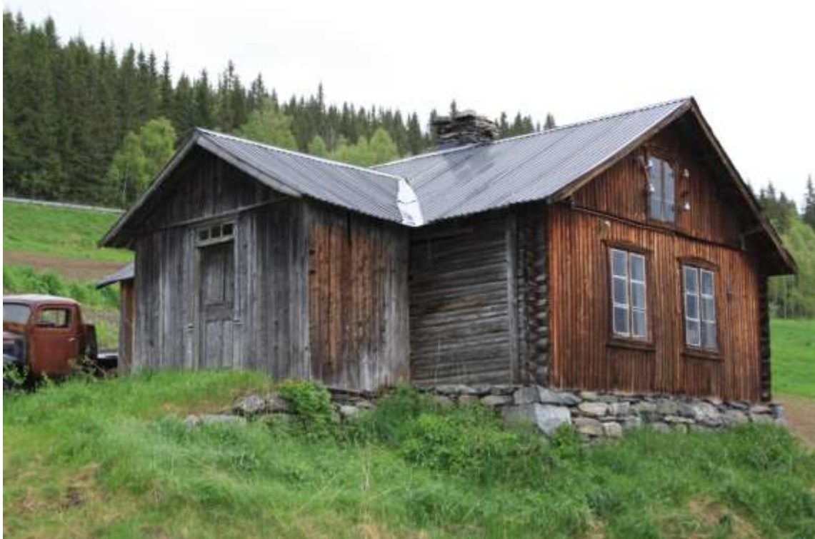
Figur 133. Kårhuset på garden står i opphavleg tilstand, men har mykje røteskadar.
