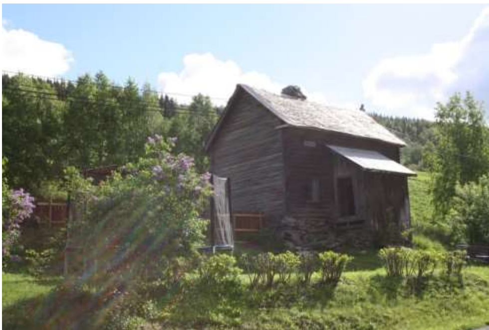
Figur 118. Øvrebygning/kårbustad sett nedanfrå. På kårbustaden er det gjort strakstiltak på murar, tak og innvendig stabilisering
